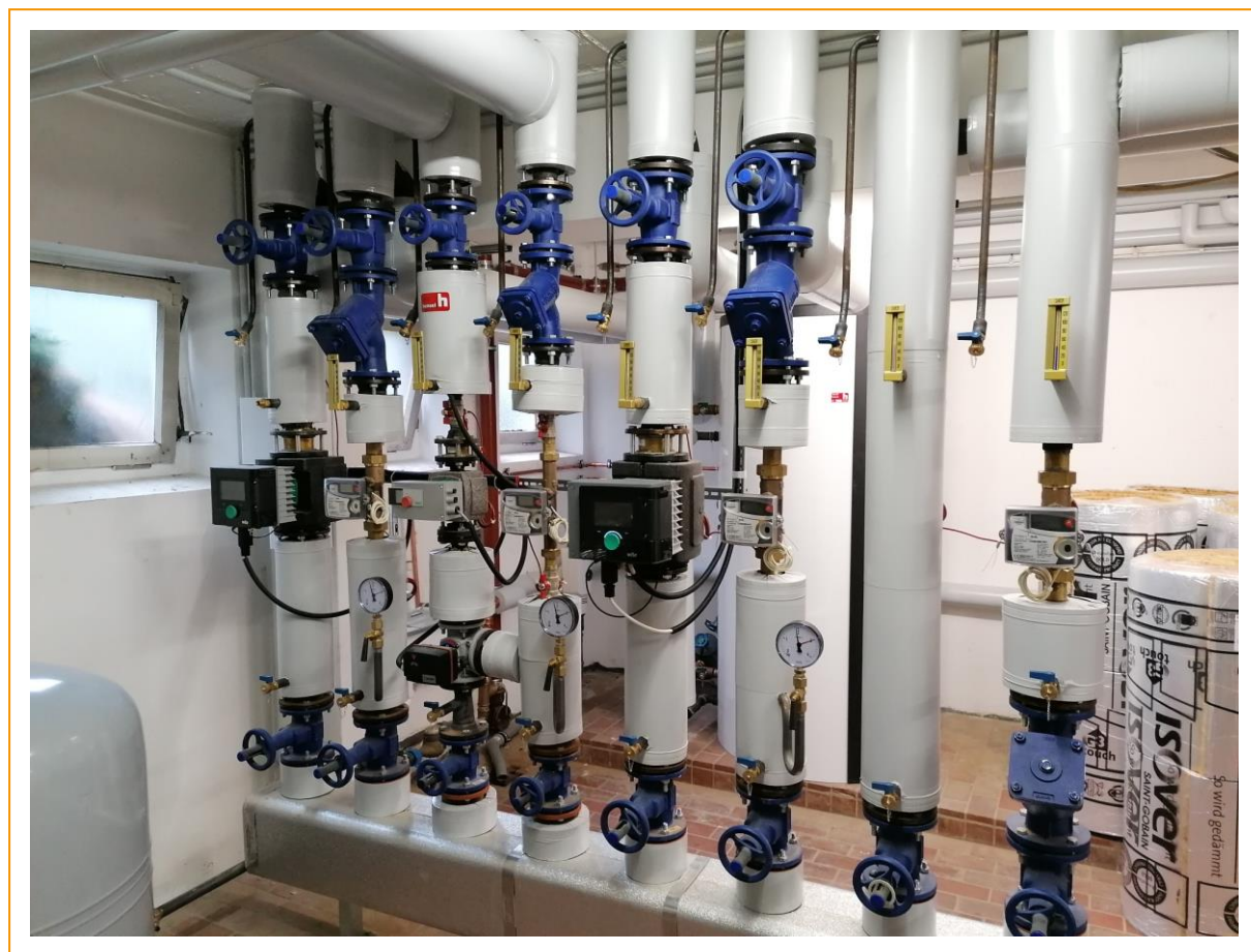
Рисунок 7 Насосы и трубопроводы системы отопления спортивного зала в г. Геестланд после энергоэффективного ремонта. Источник фото: город Геестланд
